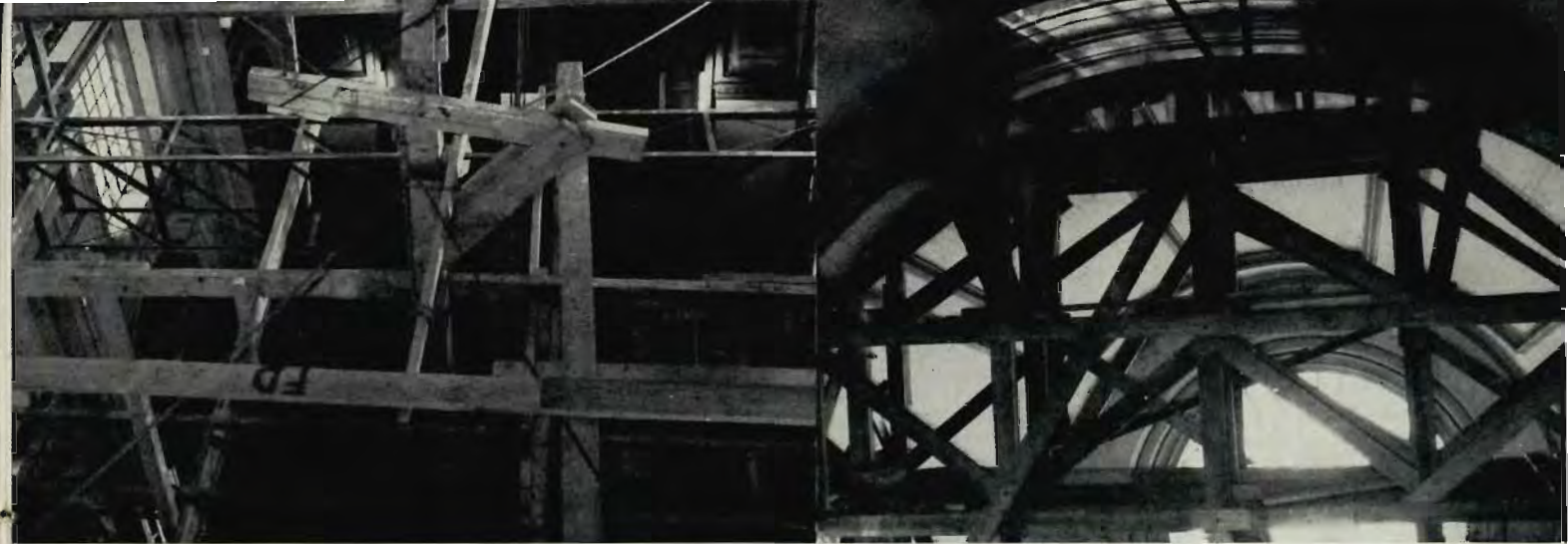
Ejemplos de grietas y diversas etapas de la restauración.
